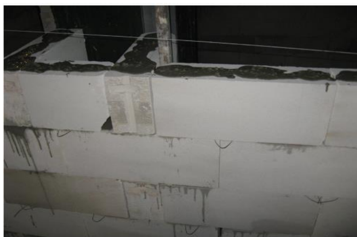
شکل ۶۶- همزدن ناکافی چسب و آب زیاد در اجرای بلوک پرین
