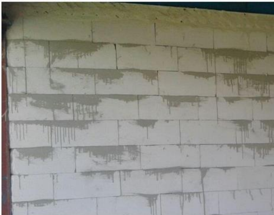
شکل ۷۳- بلوک ها به تیر و ستون بدون حائل و عدم اجرای مناسب چسب
