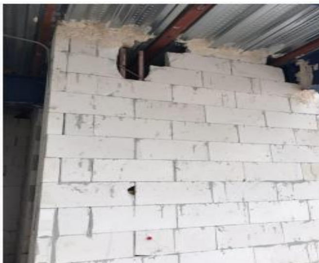
شکل ۷۴- دیوار فاقد اجرای وال پست
