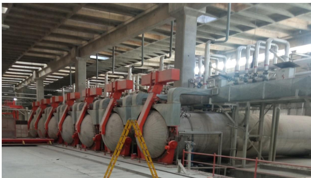
شکل ۱۰- اتوکلاوها جهت عمل آوری بلوک در دما و فشار مناسب
