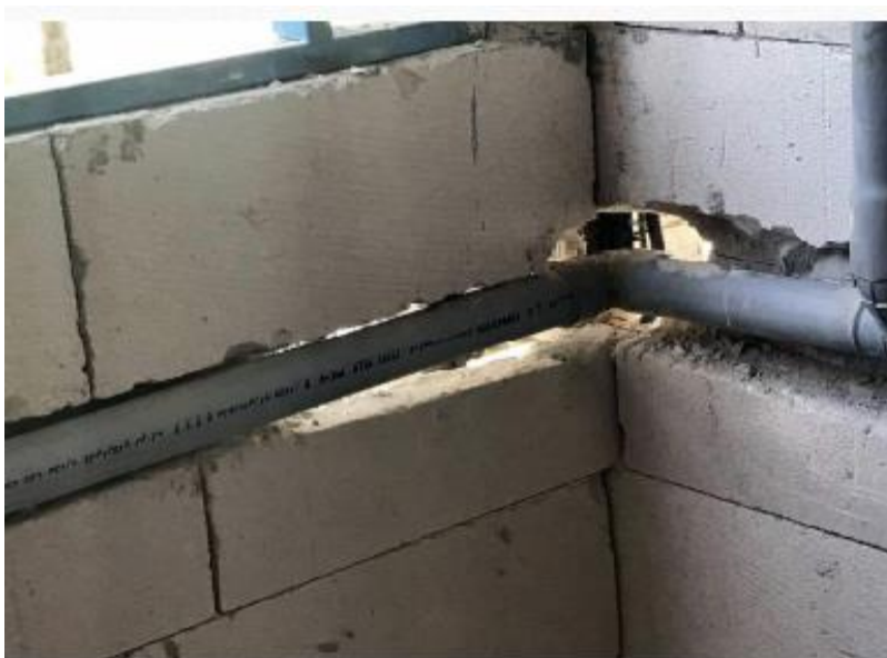
شکل ۷۵- عدم رعایت عمق مناسب شیار زنی برای اجرای تاسیسات
