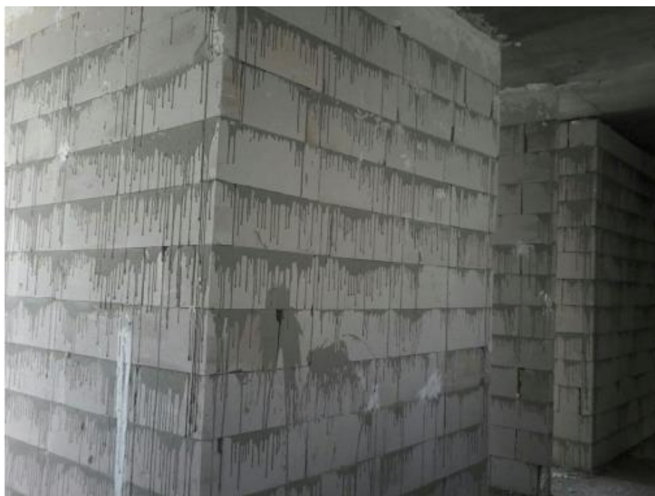
شکل ۶۸- اجرای چسب دوغابی و نبود وال پست
